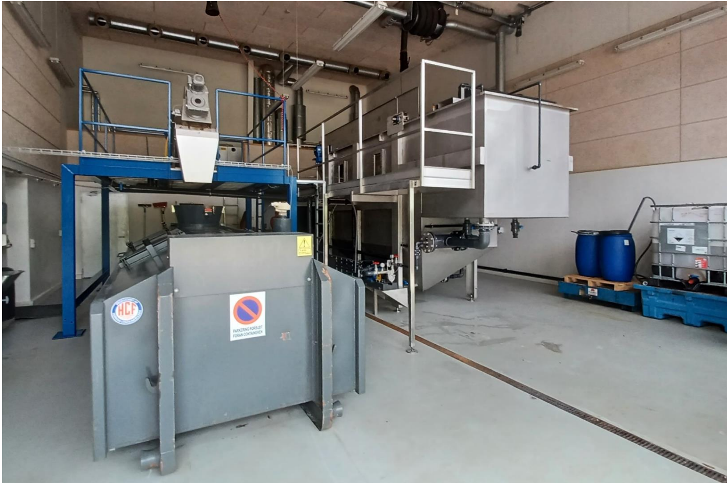
PFAS renseanlæg på Affaldscenter Skårup
