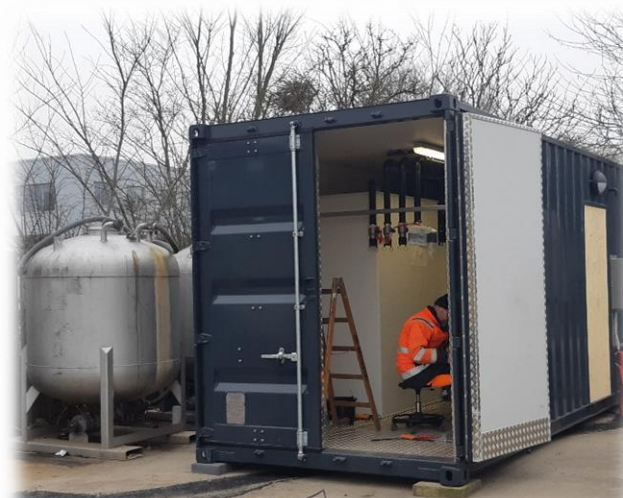
Tilslutning eksterne større kulfiltre
