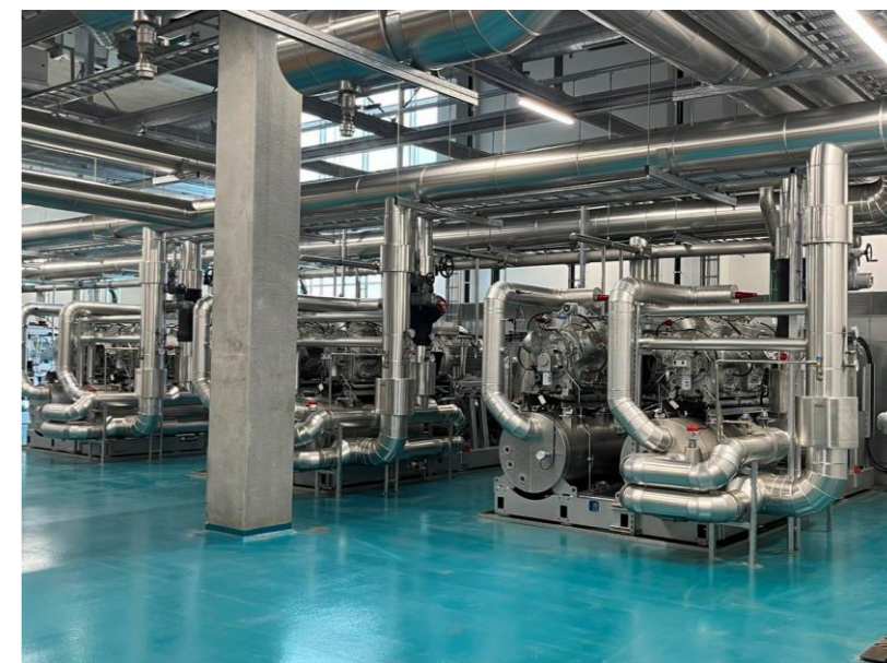
Varmepumpe på Frederiksberg Vandværk
