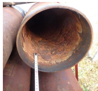
Glødeskal falder af som rustflager
